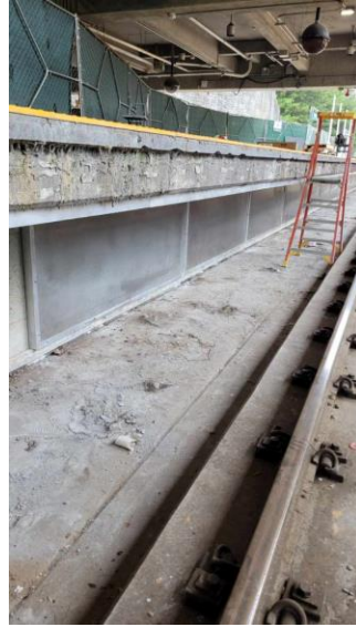
EL Track- Sound Proofing
